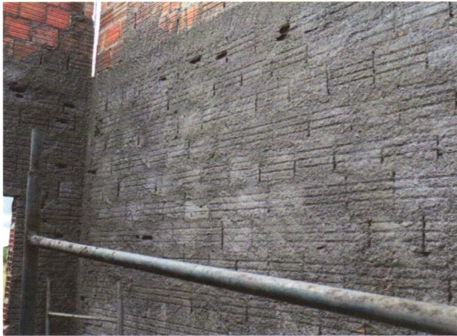
FOTO 07 - CHAPISCO APLICADO EM ALVENARIAS E ESTRUTURAS DE CONCRETO INTERNAS, COM COLHER DE PEDREIRO. ARGAMASSA TRAÇO 1:3 COM PREPARO EM BETONEIRA 400L. AF_06/2014
