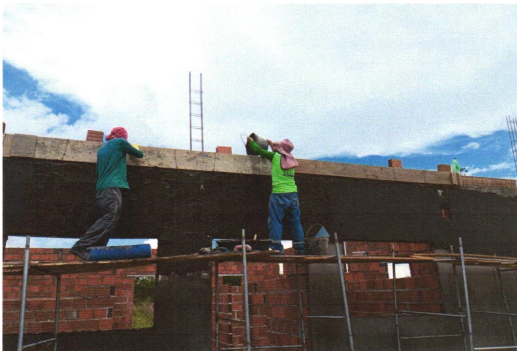
FOTO 09 – (COMPOSIÇÃO REPRESENTATIVA) EXECUÇÃO DE ESTRUTURAS DE CONCRETO ARMADO, PARA EDIFICAÇÃO HABITACIONAL UNIFAMILIAR TÉRREA (CASA EM EMPREENDIMENTOS), FCK = 25 MPA. AF_01/2017
